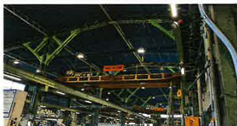
工場高天井 照明の様子
