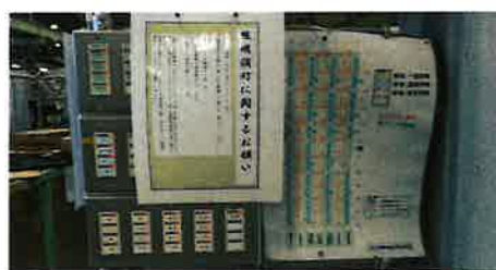
電灯の区域別個別SW化により、不要な区域で消灯を行い、電力使用量の削減しています
